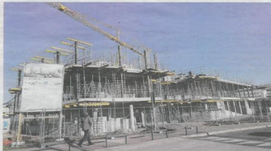
Le bâtiment en construction doit être livré à la fin du printemps. Photo Arnaud CASTAGNÉ
